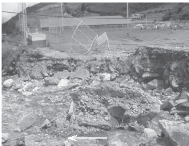
Figura 25. Pueblo Llano, muro de protección de concreto destruido por la crecida en la margen derecha de la quebrada.
