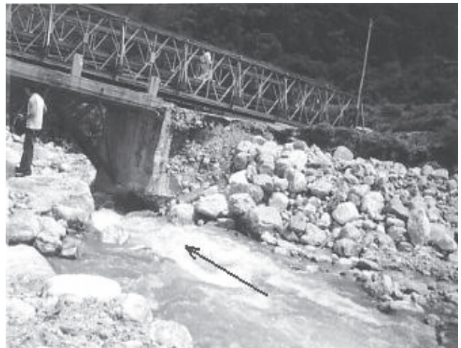
Figura 15. Socavación causada en el estribo por el río, puente de guerra colocado por la emergencia.
