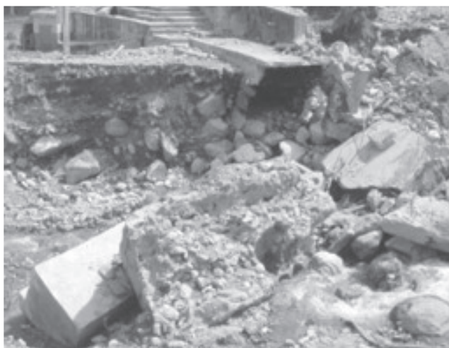
Figura 26. Pueblo Llano, puente de acceso a las canchas, destruido por la crecida.
