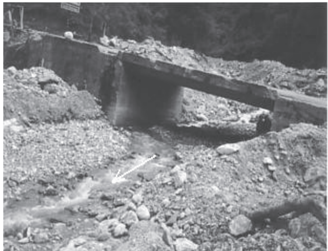
Figura 3. Materiales depositados por la quebrada La Sucia, aguas abajo del puente.
