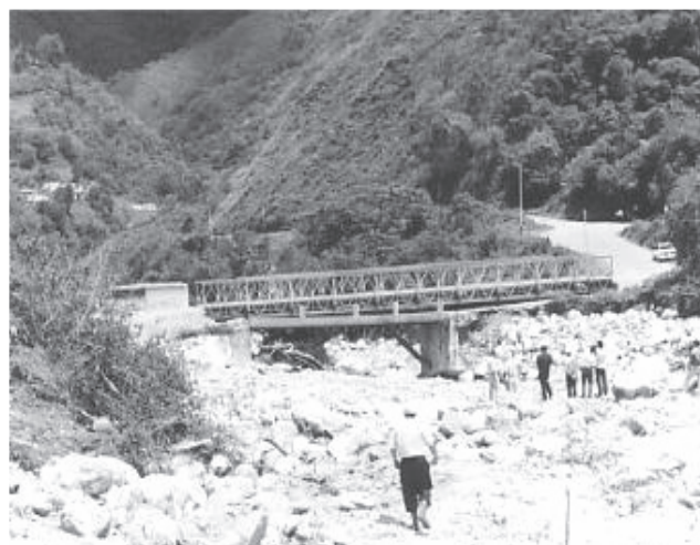
Figura 11. Puente Las Piedras, daño causado por la crecida, obstrucción del puente por escombros.
