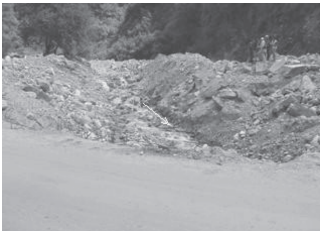
Figura 2. Materiales depositados por la quebrada La Sucia, aguas arriba del puente.
