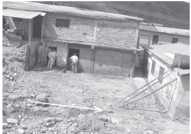
Figura 22. Pueblo Llano, daños causados en la margen izquierda por la crecida de la quebrada del Pueblo.
