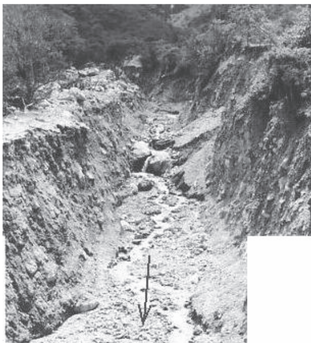
Figura 17. Quebrada Santa Filomena, sobre la carretera hacia Pueblo Llano, vista hacia aguas arriba, se observa la erosión causada por la crecida de Junio, antes de la crecida se encontraba a nivel de carretera.
