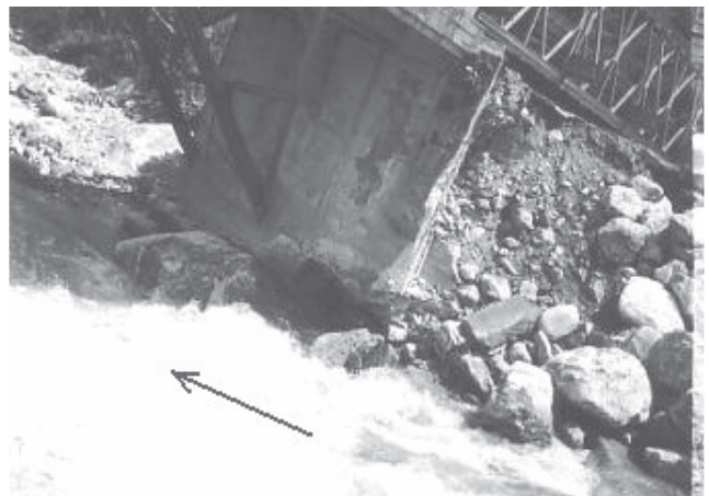
Figura 16. Detalle de la socavación causada por el río.
