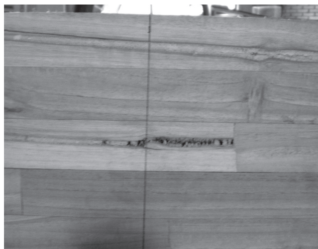
Figura 3. Vista de uno de los defectos naturales de la madera de teca, caso de médula atacada por agentes xilófagos, la cual fue encontrada en la viga N° 5 manufacturada con la técnica de finger joint . Foto: Wilver Contreras.
