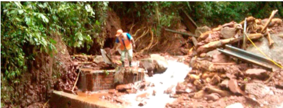
Afectación del Dique - Parte Alta (Z3).
