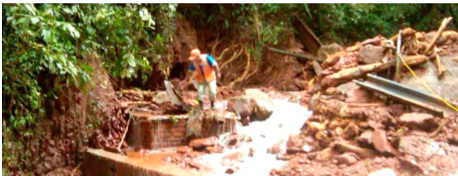
Afectación del Dique - Parte Alta (Z3).
